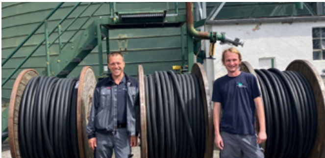
Noch stehen die alten Gebläse, die neuen Kabel für die Unterverteilung sind schon verlegt, von links: Alexander Fath, Abteilungsleiter Abwasser/Kläranlage, Michael Buchholz, Abteilung Abwasser/Kläranlage.
