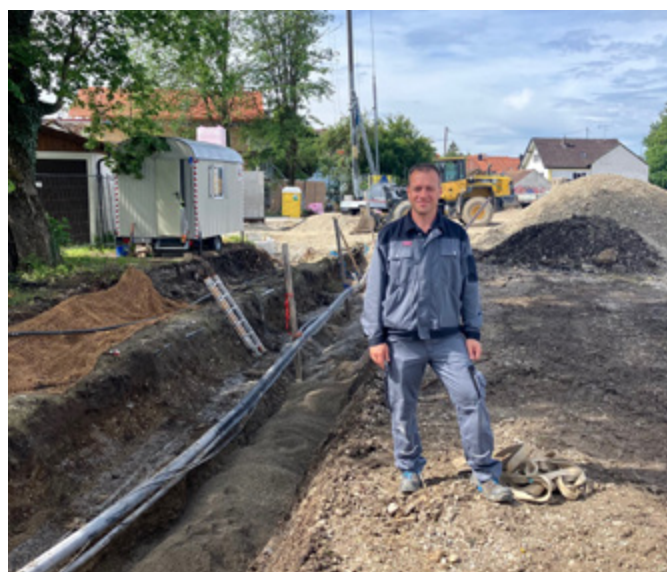
Alexander Fath, Abteilungsleiter Abwasser/ Kläranlage neben dem neuen Mischwasserkanal, der inzwischen wieder zugeschüttet ist.
