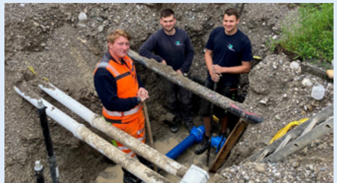
An der Baustelle Geistbühelstraße / Ecke Blütenstraße beteiligte Stadtwerke Mitarbeiter, von links: Dominik Winkler, Bereich Betriebshof, Abteilung Straße & Tiefbau; Bartholomäus Zach und Thomas Pech, beide Stadtwerke Abteilung Wasser.
