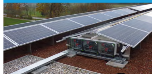
In den drei Anschlusskästen werden die einzelnen Strings der PV-Module abgesichert, verklemmt und mit dem Wechselrichter im Gebäude verbunden. Die Fühler zwischen den Modulen messen Temperatur und Sonneneinstrahlung.
