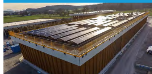
Im Herbst 2014 wurde auf den Dächern des Werkstattgebäudes (vorne) und des Verwaltungsgebäudes (hinten) der erste Teil der PV-Anlage errichtet.
