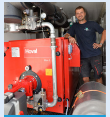
Blick ins Innere vom Stadtwerke Heizmobil.
