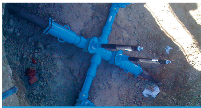
Konsequent sanieren die Stadtwerke die Infrastruktur für die Wasserversorgung. Hier wird der Schieber erneuert, mit dem bei Baumaßnahmen abschnittsweise das Wasser abgesperrt werden kann.
