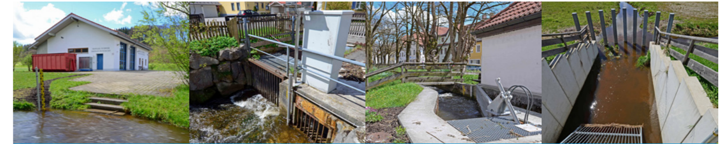
Wir haben elektronische Pegelmessstellen mit automatischem Frühwarnsystem installiert im Marnbach, Simmetsbach, Obere Stadt, Rückhaltebecken
