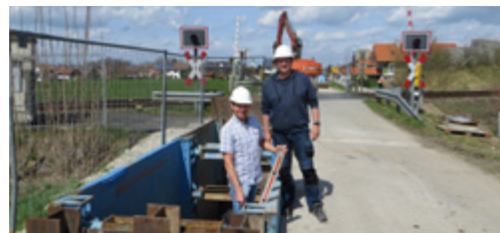
Thomas Schekira, Bereichsleiter Wasser, Abwasser (links) und Wassermeister Franz Seiler (beide Stadtwerke Weilheim) überprüfen die Startgrube. Durch das braune Schutzrohr aus Stahl wurde die neue Wasserleitung (blau) für den Lückenschluss verlegt.
