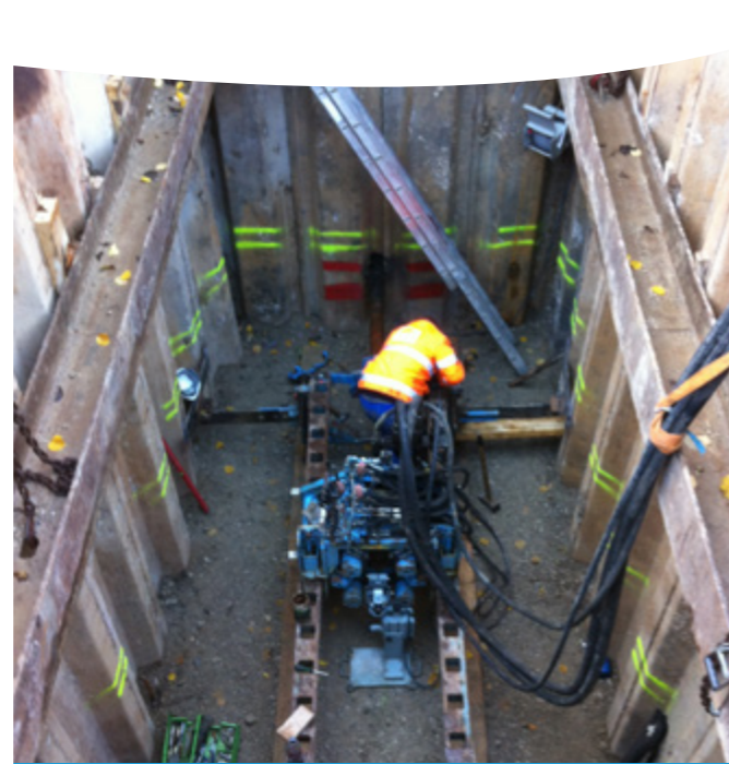
Beim Horizontalbohr-Pressverfahren wird zunächst ein Stahlschutzrohr unter den Gleisen hindurchgepresst. Die Vorarbeiten sind hier gut zu erkennen.
