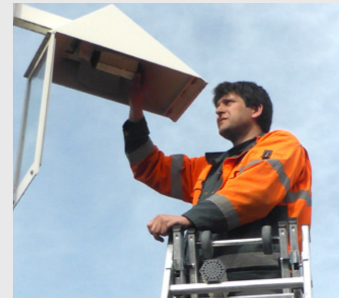
Johann Thalmayr, Elektriker vom Stadtwerke Betriebshof tauscht alte Natriumdampflampen durch neue, energieeffiziente LED-Lampen aus.
