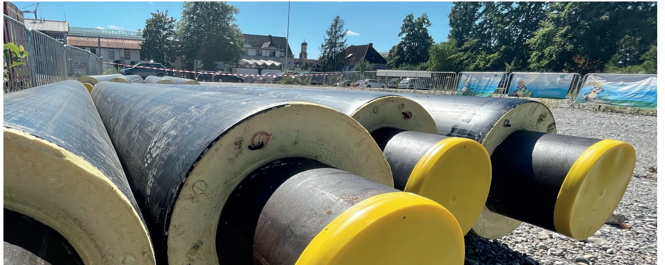
Über solche Fernwärmerohre gelangt die Wärme zu den Haushalten
