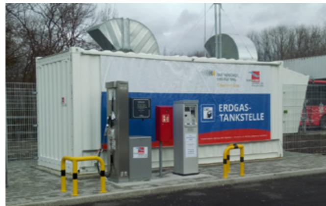
Die neue SWE Erdgastankstelle in Weilheim ist jetzt geöffnet.
