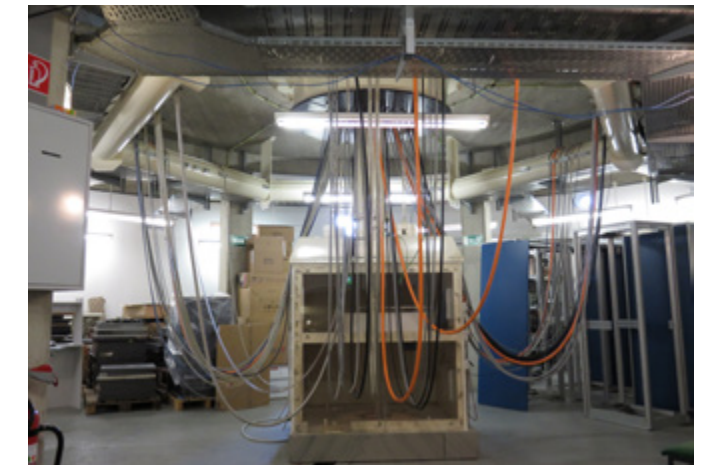
Rund 380 Tonnen Satellitenanlage liegen über dem Technikraum mit z.B. Strom oder Glasfaserkabeln.
